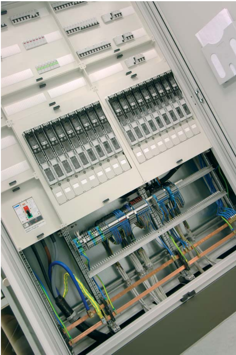
Een door de kast- en paneelbouwer samengestelde schakel- en verdeelinrichting dient volgens de Europese Laagspanningsrichtlijn te voldoen aan de norm NEN-EN-IEC 60439.
